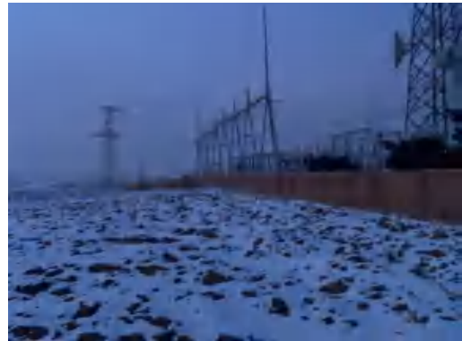
伊通 220kV 变电站西侧出线间隔
